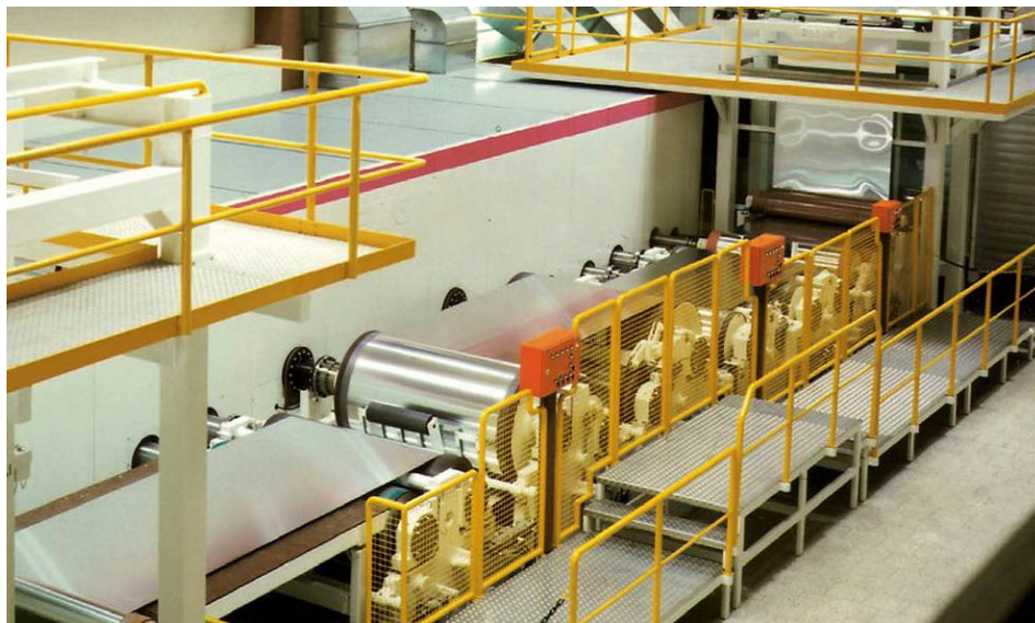
Reckanlage (Werksfoto: Hydro)
